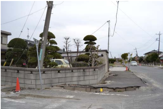
3 日の出住宅地の住宅地盤及び道路地盤の沈下
