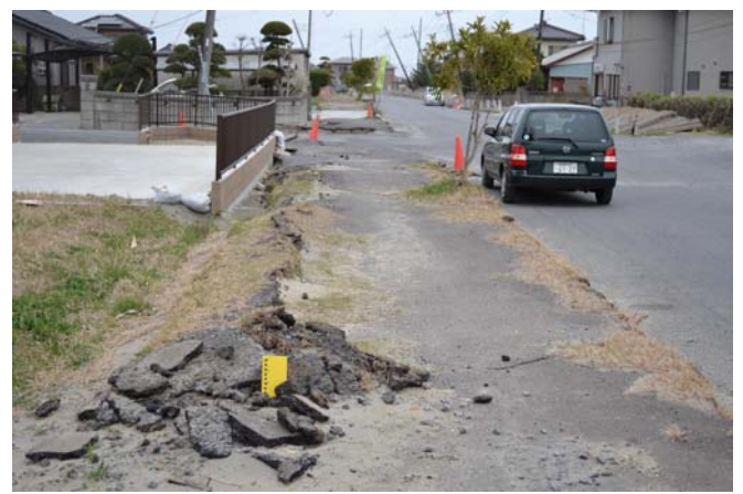
2 日の出住宅地内の歩道の亀裂と液状化被害
