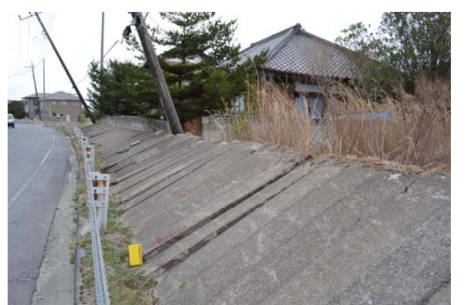
4 潮来市日の出住宅地の道路脇側溝上の歩道被害
