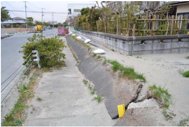
1 日の出住宅地内の道路脇歩道の被害（黄色は野帳）
