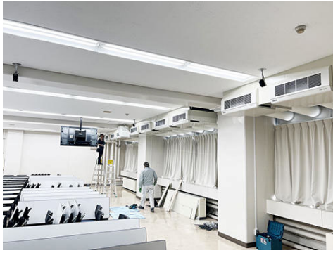
【換気設備を強化した1号館の教場】
